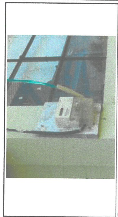
Foto 12: Balcon para protección de contador.
